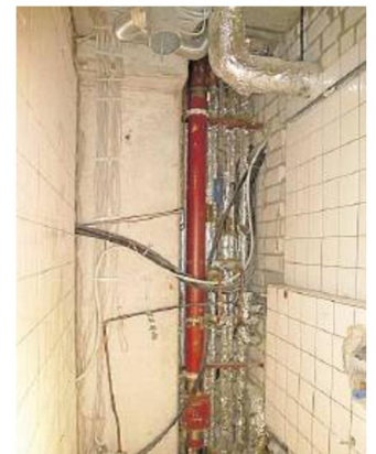
Ein Blick in den Installations-schacht mit 40 Jahre alten Abflussrohren.
