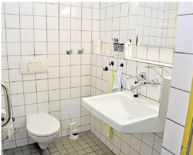
Dieses Bad auf der Geriatrie-Station ist 34 Jahre alt. Das Waschbecken kann nicht mit einem Rollstuhl unterfahren werden.
